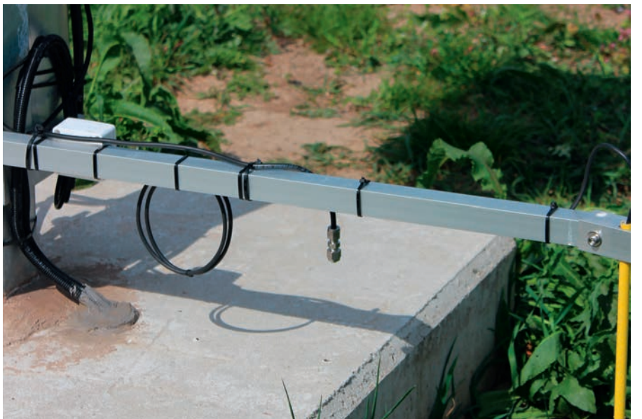
Abb. 2: Auslass mit Blindstopfen, noch ohne Probenahmesystem bzw. Messsensorik.
